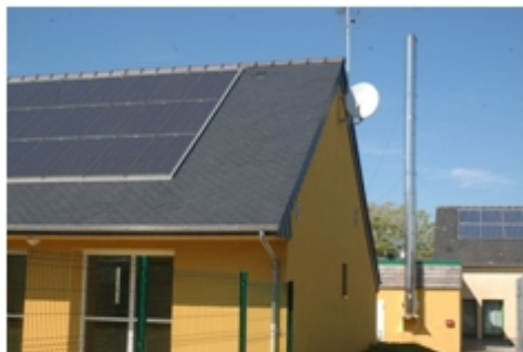
La chaudière bois au pôle enfance
